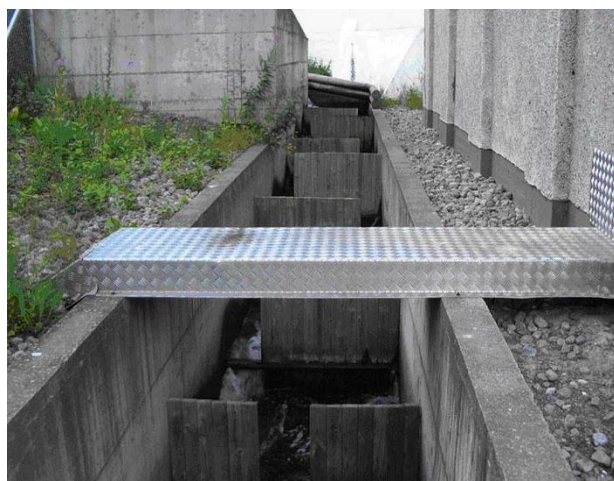
Рибопропускні спорудження на ГЕС Коівукоскі, м. Котка, Фінляндія
